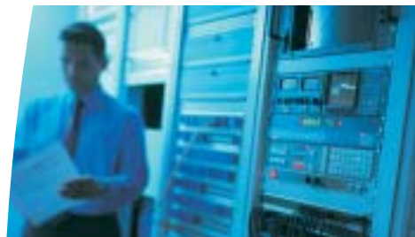
Server, Datenspeicher und Netzwerkkomponenten.
